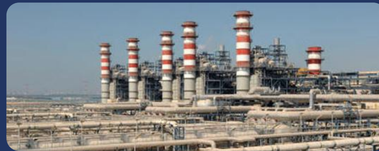
استكمال أعمال محطات كهربية بمحطة رابغ للطاقة Completion of electrical plant works at Rabigh Power Station
